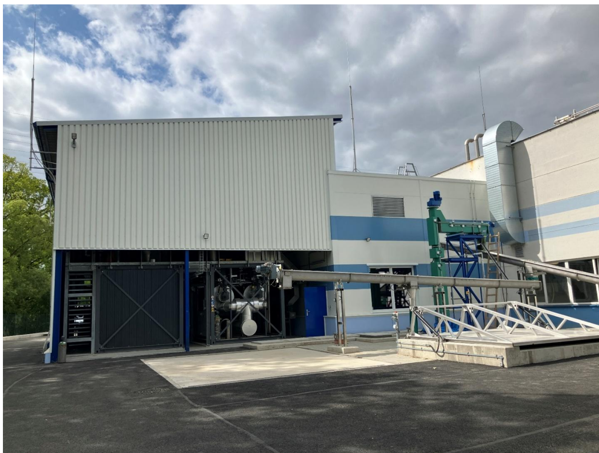
Obr. 3. Přístřešek pyrolyzéru, v popředí zhlaví kalového bunkru s dopravníky
