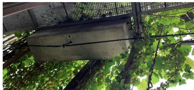
Obr. 22. Detailní pohled na rozvod kapkové závlahy do truhlíků na fasádě budovy Humboldtovy univerzity v kampusu Adlershof v Berlíně, 2022
