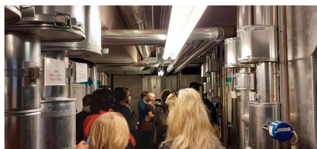
Obr. 23. Podzemní zázemí závlahového systému zelené fasády v budově Humboldtovy univerzity v kampusu Adlershof v Berlíně, 2022
