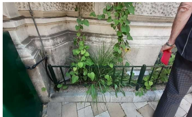
Obr. 10. Kapkovací potrubí u paty budovy magistrátu ve Vídni, 2024
