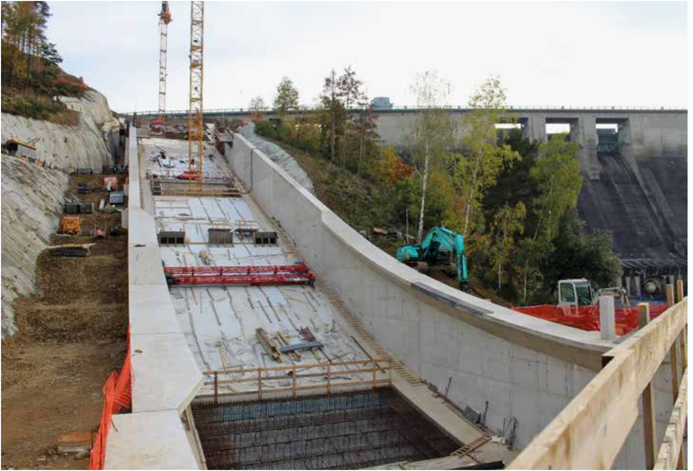
Stavba bezpečnostního přelivu na VD Orlík, stav v říjnu 2023, foto M. Malec
