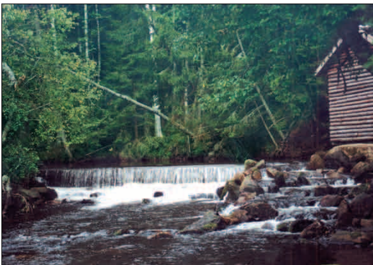
Rybí přechod – balvanitá rampa u jezu Zahrádky III na Teplé Vltavě v NP Šumava. Vybudován v roce 1999.
